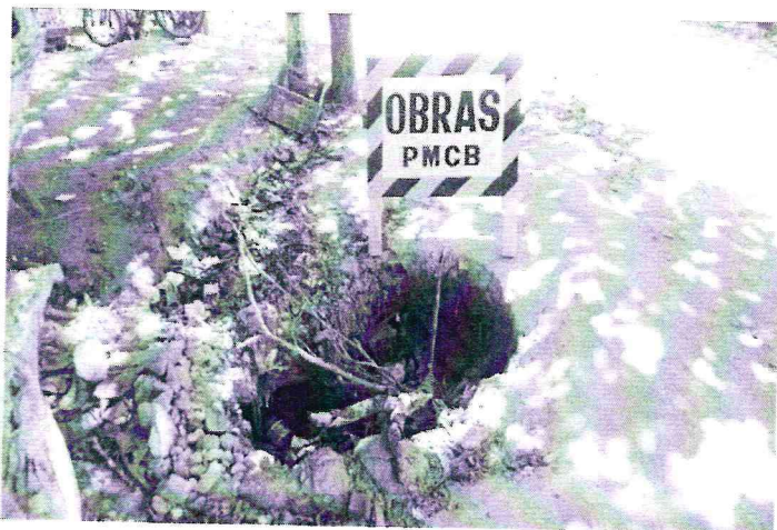
Rede de esgoto estourada
